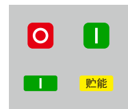
断路器合闸且已储能完毕状态
